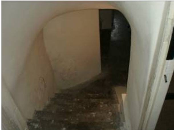
De keldertrap met rechtsboven de golving waarachter een holle ruimte is.
